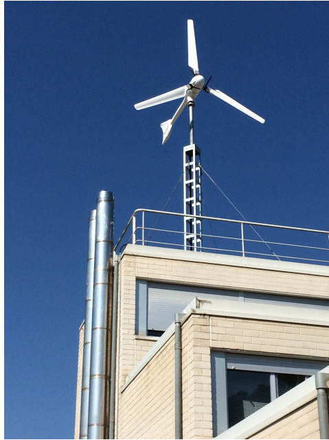
Figura 2.15: Generador minieòlic al terrat de l'edifi P2 de l'escola politècnica superior.
