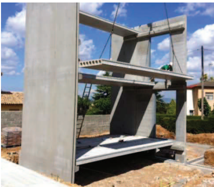
Imatge 8 i 9. Muntatge elements estructurals Imatge cedida per Prêt a Porter, PMP.
