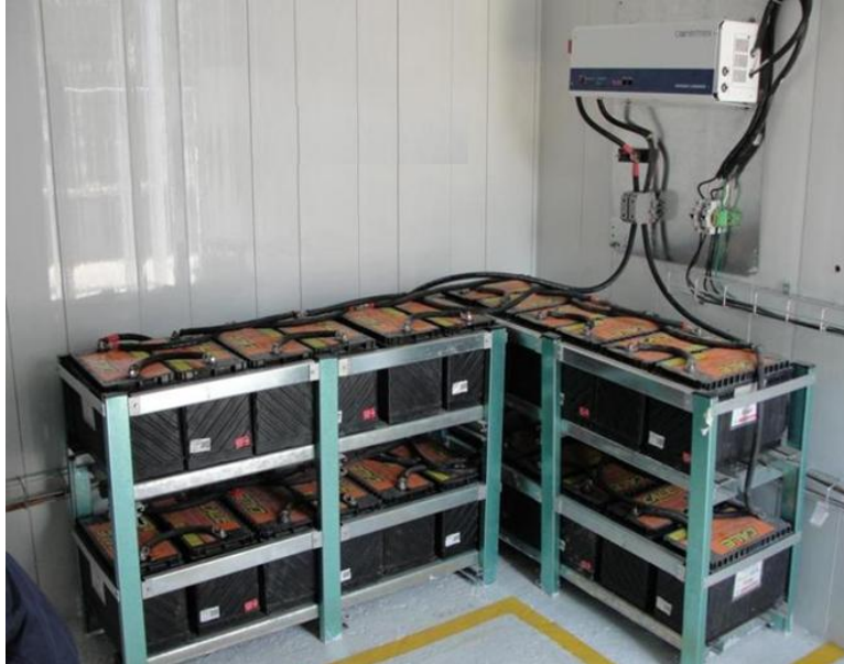
Figura A.12 Banc de bateries
