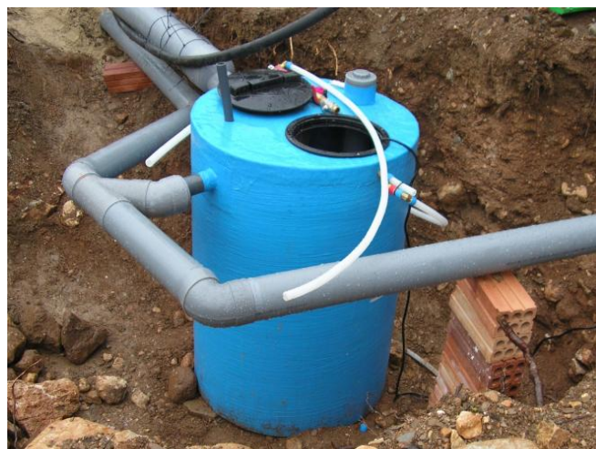
Figura A.40 Depuradora d'aigües grises enterrada
