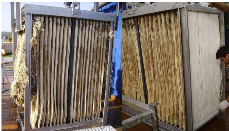
Figura 5.- Imatge dels mòduls malmesos i dels nous reemplaçats.
