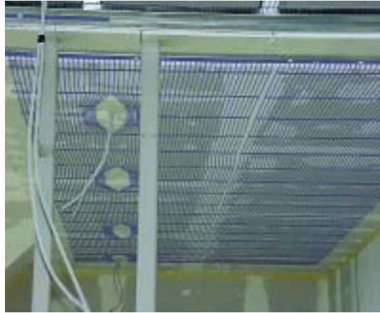
Imatge 4. Sostre radiant
