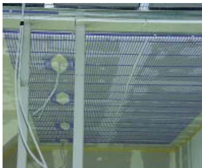
Imatge 6.5. Forats per a la sortida de cables elèctrics
