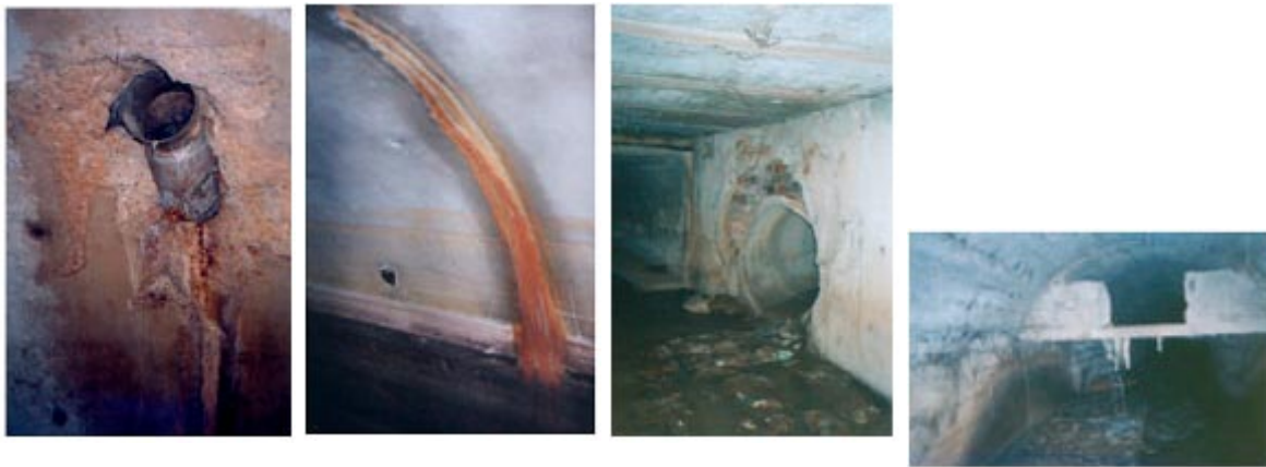
Figura 4.25. Detalls d'embornals i de col·lectors degradats per abocaments.
