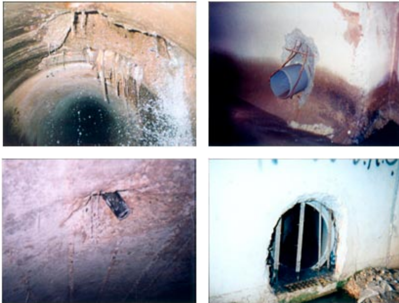
Figura 4.1. Detalls que mostren connexions il·legals o mal construïdes.
