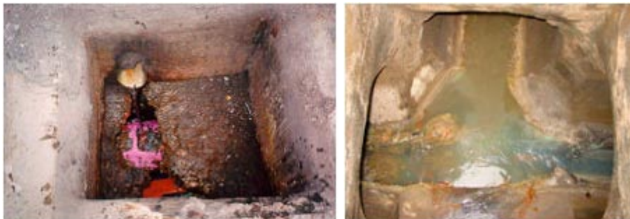
Figura 4.28. Soleres de col·lector degradades per abocament d'àcid i la consegüent contaminació de l'aqüífer per filtració.
