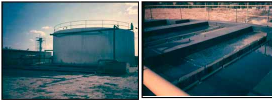
Figura 3.47. Reactor UASB. Campanes de recollida de biogàs al reactor UASB
