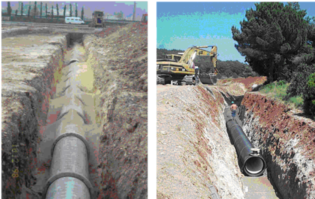
Figura 2.5 Conduccions instal·lades en les seves rases
