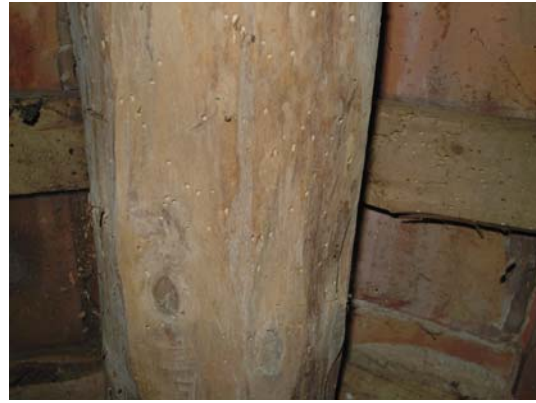
Estat actual de una biga
