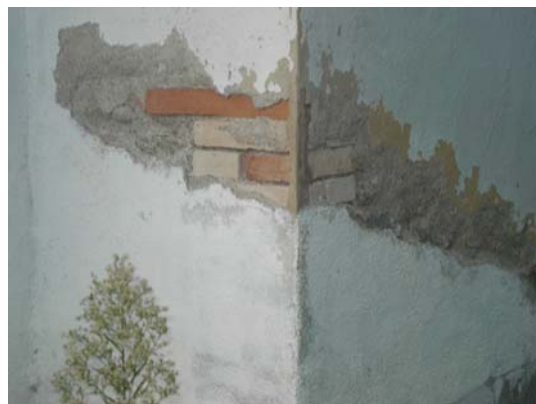
Despreniment de moreter a cantonera
