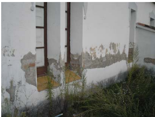
Despreniment de moreter a facana
