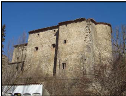
Façana lateral dreta de l'església de St. Julià, on s'observen els efectes de la caiguda del llamp.
