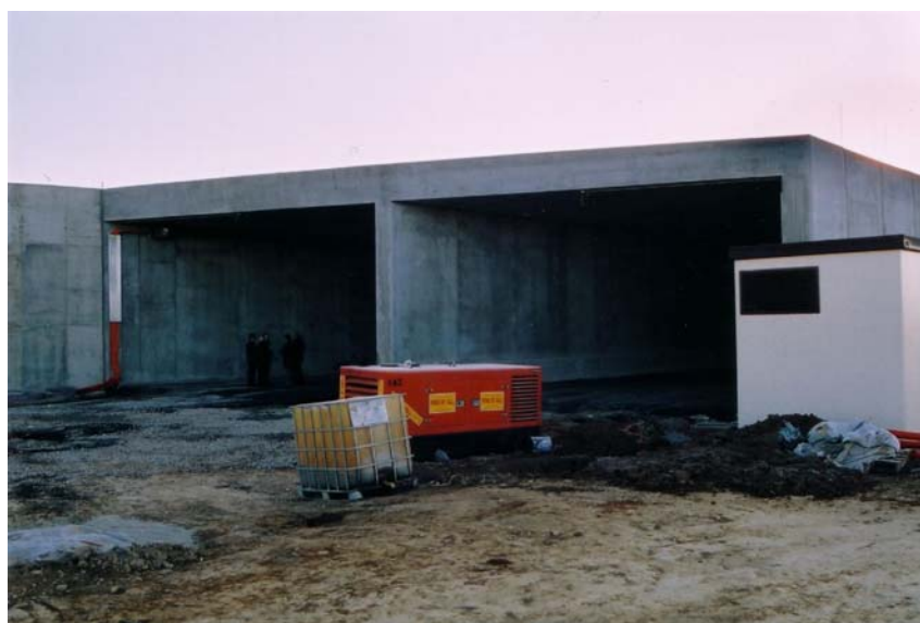
Figura 27: Estructura acabada a base de muros y losa superior semi-prefabricados en la Ronda Norte de Sant Cugat.
