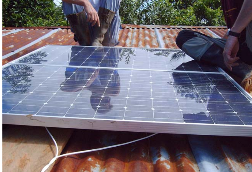
Figura 16.- Panel Solar montado en Atahualpa Fuente: ESF
