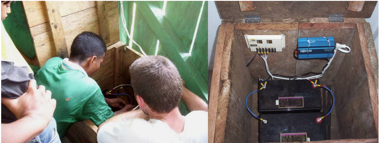
Figura 52 i 53.- connexió dels elements a Brisas del Tiputini i Flor de la Palma (font: ESF-2006)
