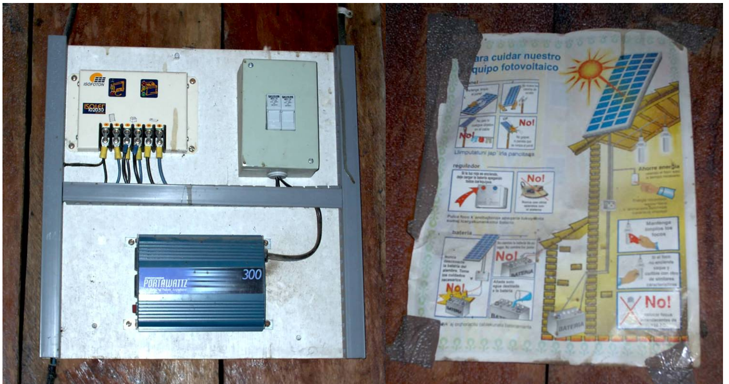
Figura 12 i 13.- Instal·lació Solar escola de la comunitat Rey de los Andes (font: ESF-2003)
