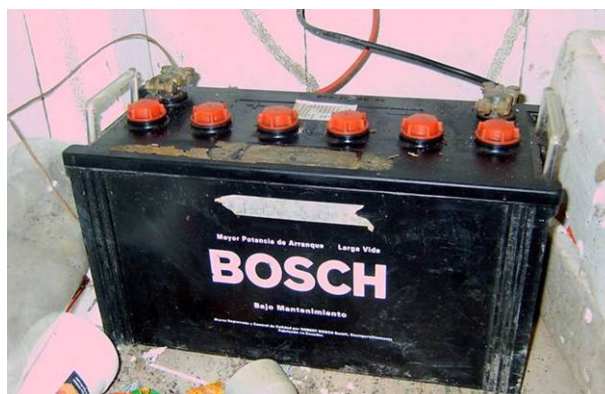
Figura 3. Bateria de les instal·lacions del projecte de Sandi Yura (Font: ESF)
