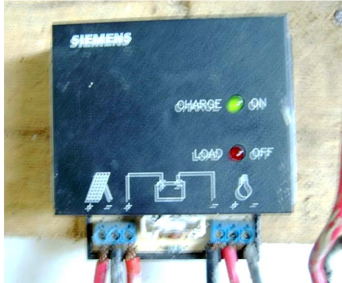
Figura 16.- Regulador Siemens SR04 de Llançama (font: ESF-2005)
