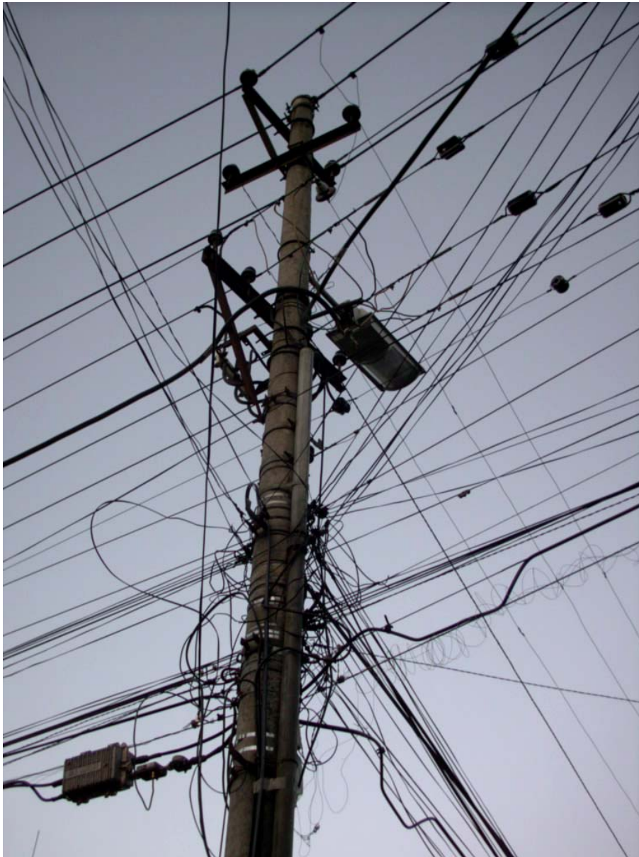
Figura 10.- Pal per al pas d'instal·lacions elèctriques i de telèfon de Quito (font: ESF-2003)
