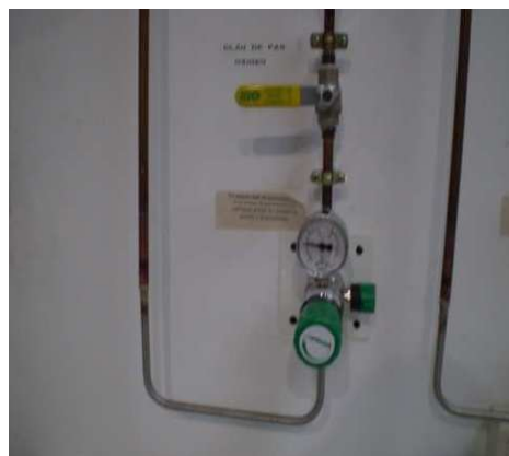
Figura 31: Aixetes capals manoreductors (conjunt manòmetre i regulador de pressió).
