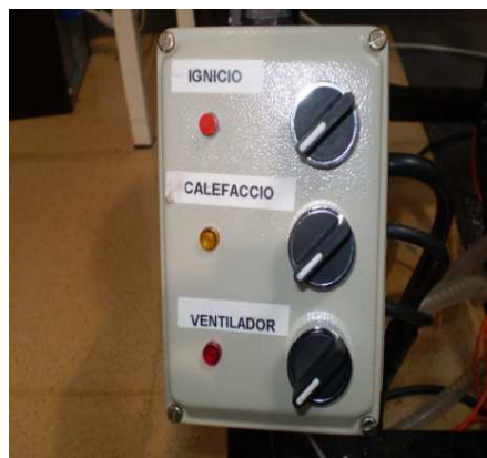
Figura 25: Interruptors fixos a la bancada.
