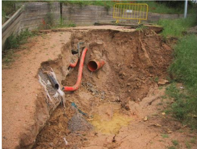
Figura 2: Foto del tub de drenatge trencat (Font: Lithos Geotècnia)
