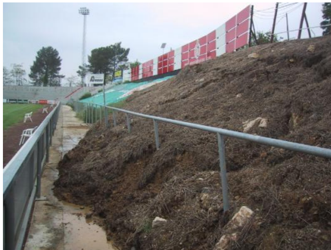
Figura 36: Foto de l'esllavissament de l'any 2004 (Font: Lithos Geotècnia)
