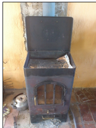
Caldera de biomassa
