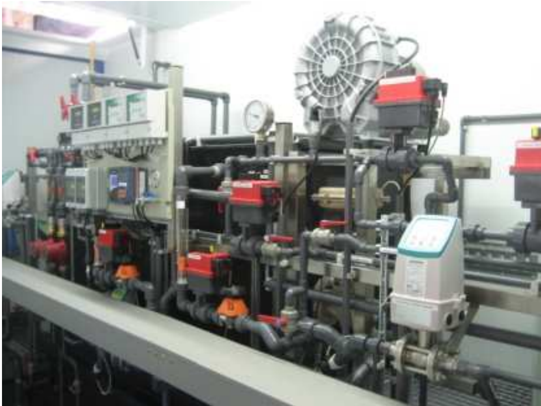
Figura 3. Imatge de l'interior de la planta pilot
