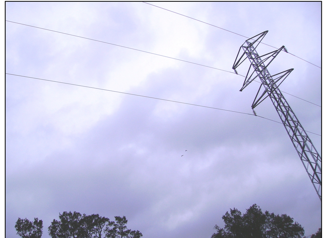
Fig. 35. Línia elèctrica dins l'Hàbitat passera 2
