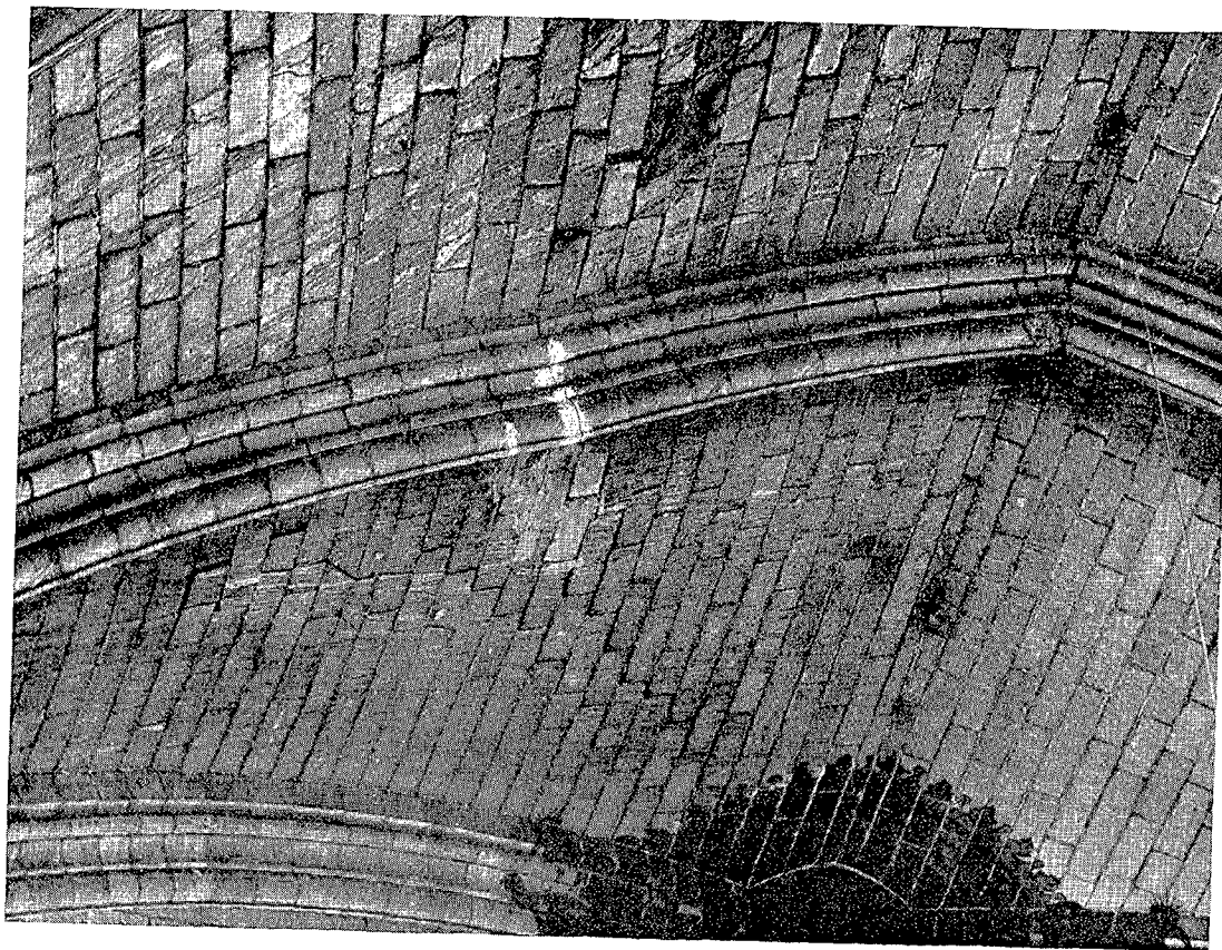
Detalle del arco en el que se aprecia su alarmante depresión.
