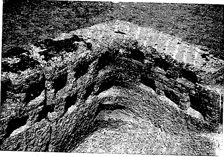
Uno de los ángulos de la terraza superior con los orificios para la sustentación de las vigas de la cubierta.
