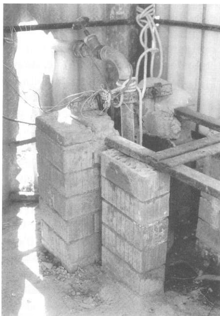
Interior de la captació del pou de mas Reixac.
