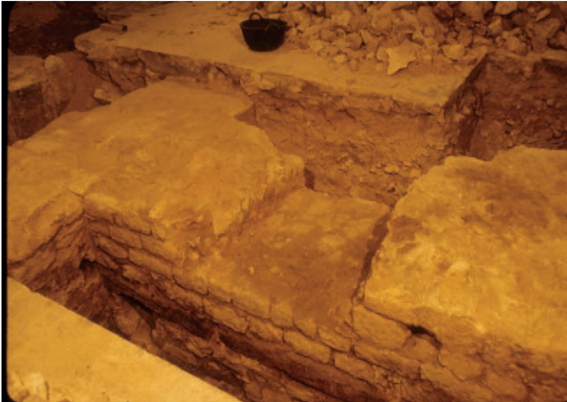
Fig. 40g. Detall de la tècnica constructiva del pòtic. Mur u.e. 1046 des del N . Parament "llombard" de macs de calcària desbastats en filades regulars.
