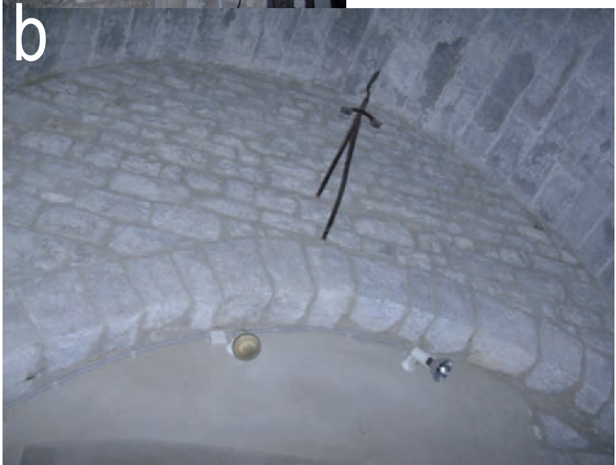
Fig. 236. Capella de Sant Rafael: a) arrencament oest de l'arc superior, encastat al reforç nord-est de la Torre de Carlemany; b) parament interior del mur damunt l'arc.
