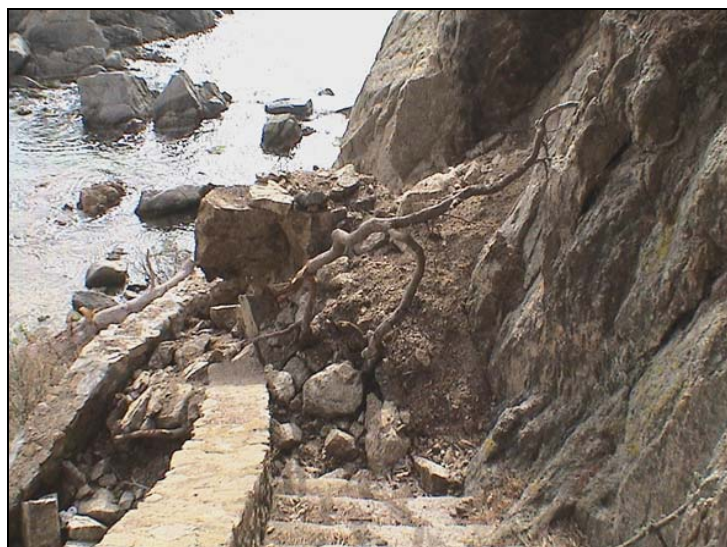
Figura 12.21.- Camí de ronda de Calella, sector 14, escales d'accés a la platgeta de Sant Roc (març de 2004)
