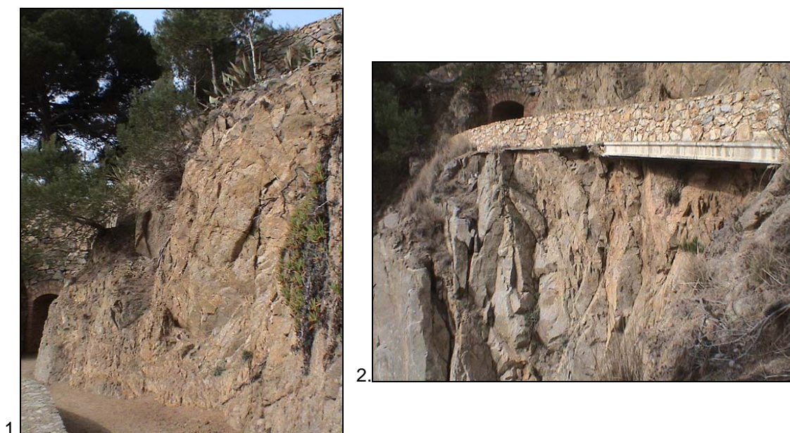
Figura 12.17.- Camí de ronda de Calella, sector 12. (1.- visió general i (2.- detall dels desprendiments a la base del camí de ronda (març de 2004)
