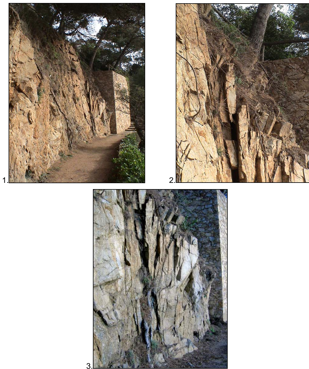
Figura 12.10.-Camí de ronda de Calella, sector 7. (1.- visió general i (2.- detall de blocs inestables (març de 2004). (3.- eixamplament de les diàclasis pel creixement i penetració de les arrels
