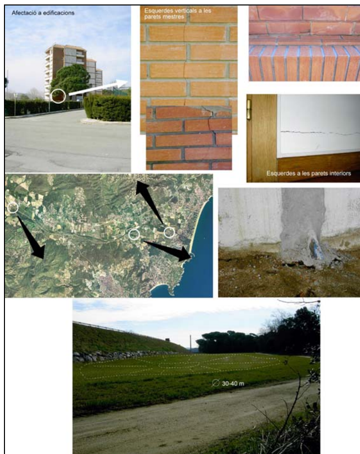
Figura 10.17.- Exemples de deformacions del terreny i edificacions que podrien tenir l'origen en canvis tensionals ocasionats per l'explotació d'aigües subterrànies
