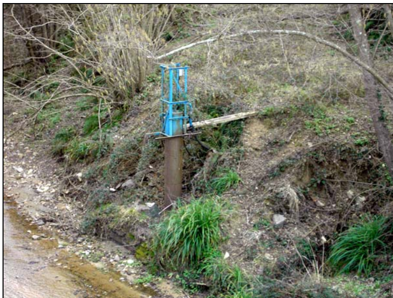
Figura 10.27.- Pou del paratge de Mas Patxot descalçat com a conseqüència de la inestabilitat del marge de la riera provocada pel canvi en les condicions del nivell freàtic
