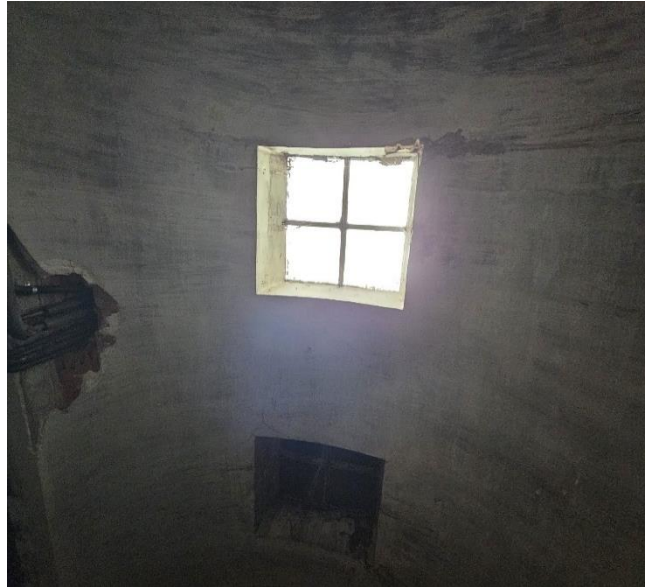
Figura 6:Claraboia situada a la sala de màquines. Font: pròpia.
