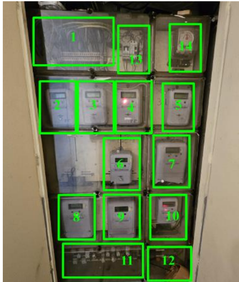
Figura 5: Distribució de la centralització de comptadors. Font: pròpia.
