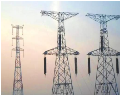
Figura 24: Suports elèctriques amb cables suspesos i ben separats però sense aïllar. Font: web
