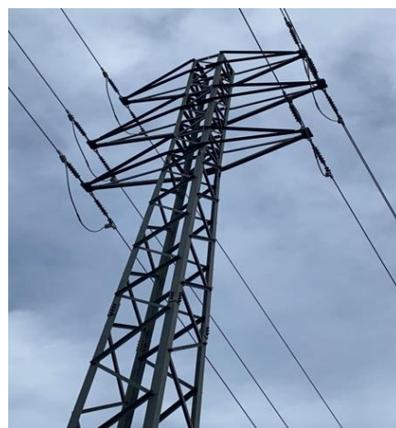
Figura 4: Suport elèctric amb els conductors sense aïllar però suspesos. Font: pròpia
