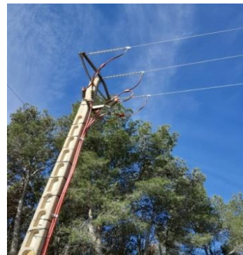
Figura 25: Suport elèctric amb conductors aïllats amb tub termo-retràctil. Font: pròpia
