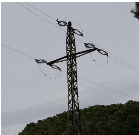
Figura 3: Suport elèctric amb els conductors exposats i sense aïllar. Font: pròpia
