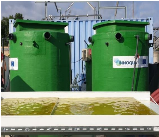
Figura 7: Planta pilot a l'EDAR de Quart
