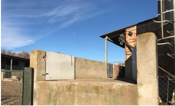
Figura 23: Sistema de càrrega i descàrrega adaptat a la nova normativa. Explotació Santa Eularieta. FONT. Elaboració pròpia.
