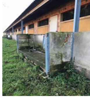
Figura 24: Sistema de càrrega i descàrrega antic. Explotació Santa Eularieta. FONT. Elaboració pròpia.
