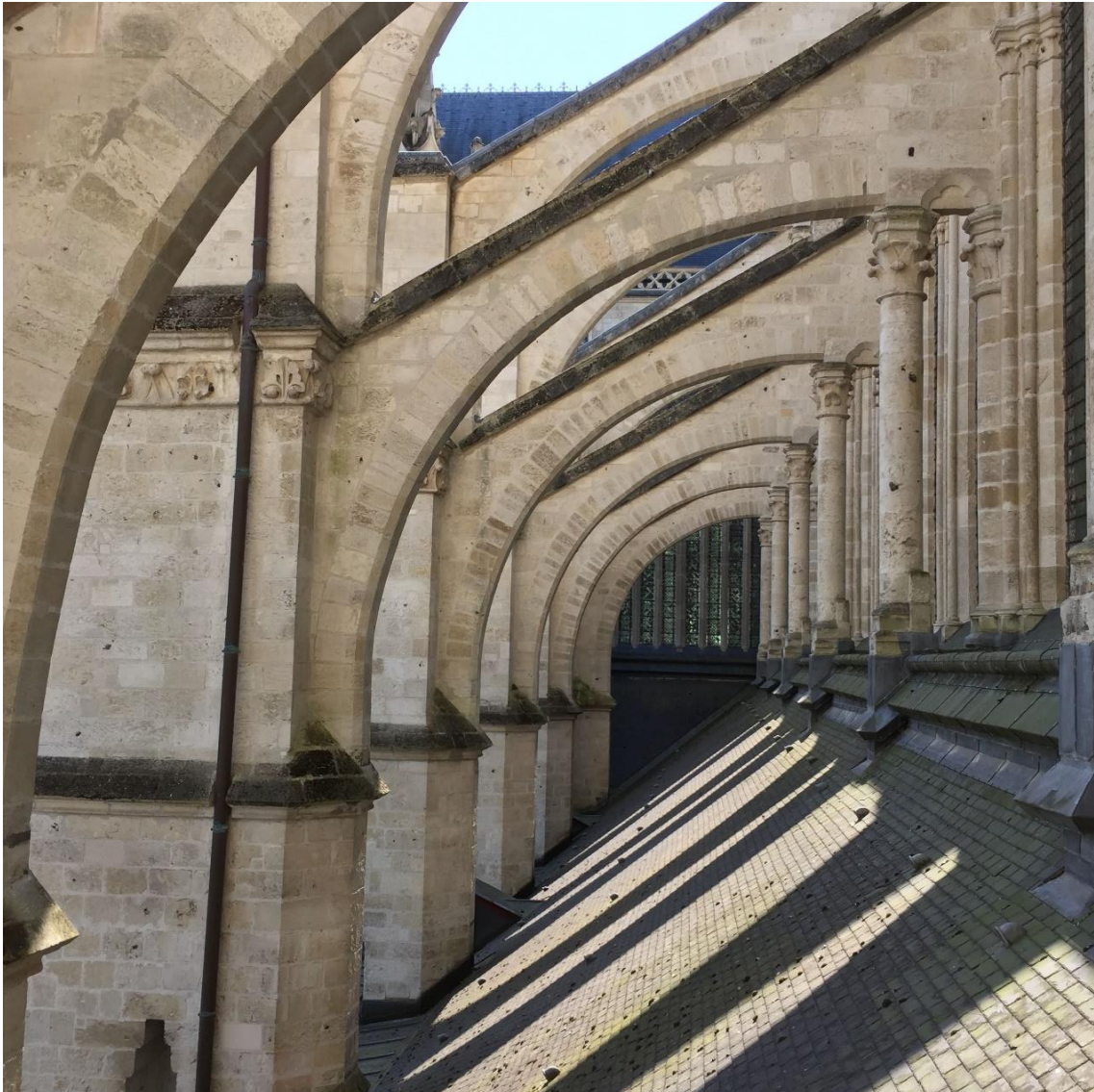
Figura 21. Fotografía de los arbotantes de la Catedral de Amiens. Fotografía realizada por el autor.
