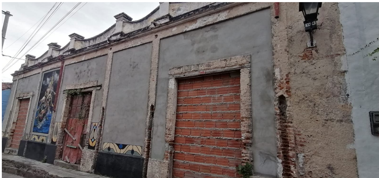
Figura 35 Vivienda del centro histórico deteriorada.
