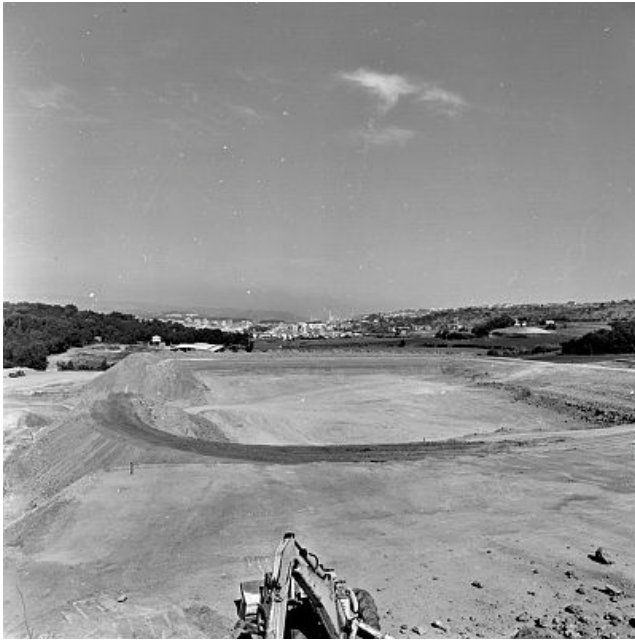
1968: Obres del nou camp de futbol de l'equip del Girona, a Montilivi. Girona.
