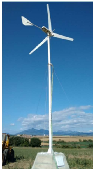
Figura 2. Estructura mecànica de l'aerogenerador a l'Ecogranja Vilà.
