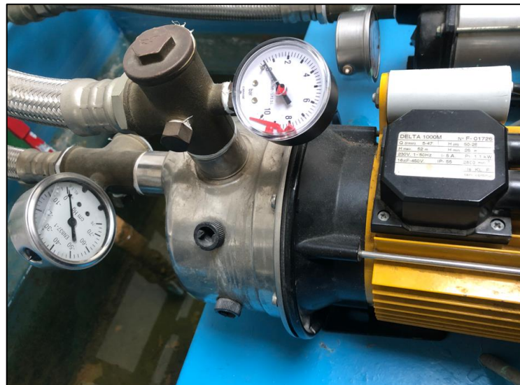
Figura 4. Situació del manòmetre i vacuòmetre a la bomba monoetapa existent del banc
