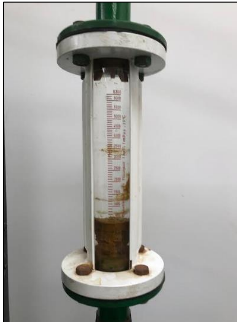
Figura 5. Cabalímetre actual del banc de proves
