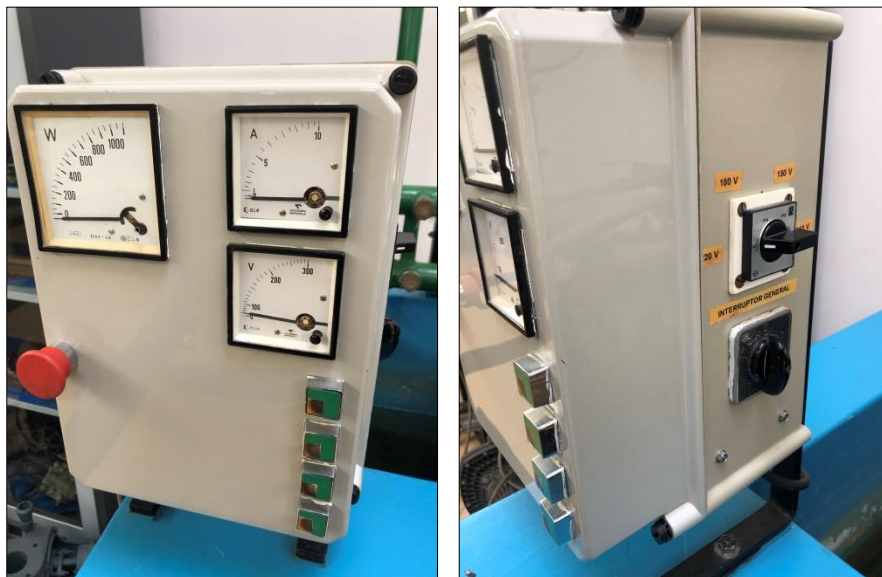
Figura 6. Quadre de control circuit hidràulic
