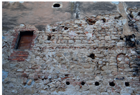
Figura 14. Façana interior de l'ala est del claustre, on es pot veure la ubicació de la coberta de teula ceràmica fossilitzada al mur per sobre de la finestra romànica. 17/NOV/2021 (E. Píriz).
