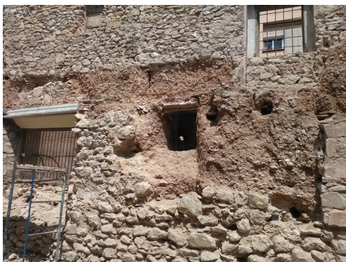
Fig. 7. Vista d'un tram de muralla amb restes del sòcol i l'elevació de parament de tàpia. Foto: Josep M. Vila.
