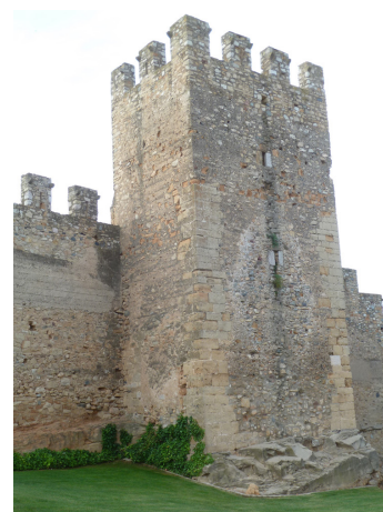
Fig. 6. Vista d'una de les torres de la muralla on s'observen les dues fases constructives medievals i el recreixement coronat amb merlets a principis de la dècada de 1950. Foto: Josep M. Vila.
