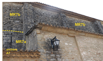
Fig. 9. Saint-Laurent-la-Vernède. Eglise, gouttereau nord MR7. Vue générale de la surélévation MR7b. En bas, à gauche, on remarque la maçonnerie antérieure MR7a, percée d'une longue archère droite A7. © F. Loppe, 2021.
