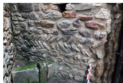
Fig. 26. Saint-Pons-la-Calm. Mur MR4a, parement intérieur ouest. Vue détaillée de l'assise en opus spicatum . © F. Loppe, 2022.
