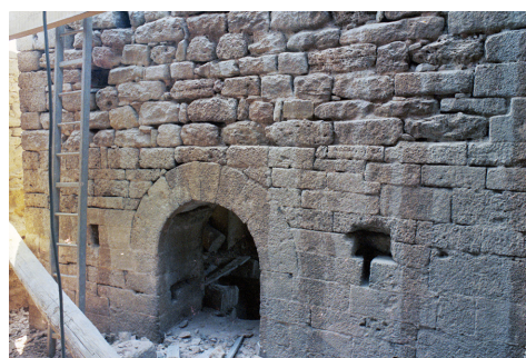
Fig. 10. Saint-Laurent-la-Vernède. Eglise, gouttereau sud MR8. Vue générale de la surélévation MR8b. On note les piédroits conservés de la porte surélevée POR2, à droite, et le haut de l'archère A8, à gauche. © F. Loppe, 2021.
