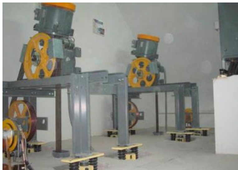
Figura 26: Motor d'elevador amb amortidors
