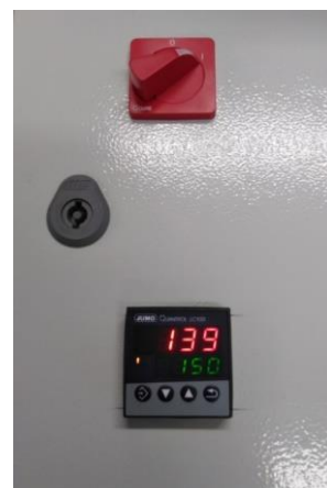
Figura 4: Part exterior del quadre elèctric
