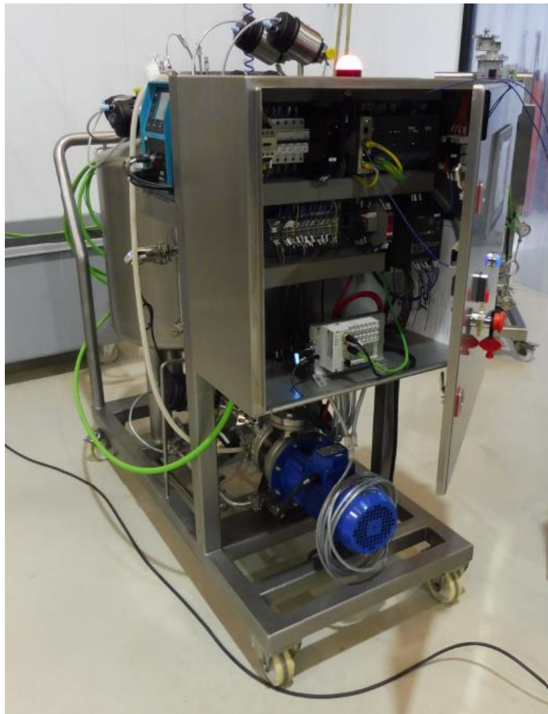
Figura Annex 84: Equip CIP amb l'armari elèctric obert
