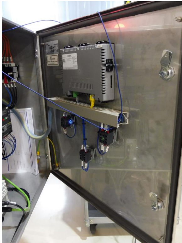
Figura Annex 105: Tapa de l'armari elèctric de l'equip CIP
