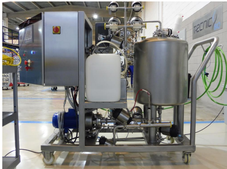
Figura Annex 87: Vista per darrere de l'equip CIP
