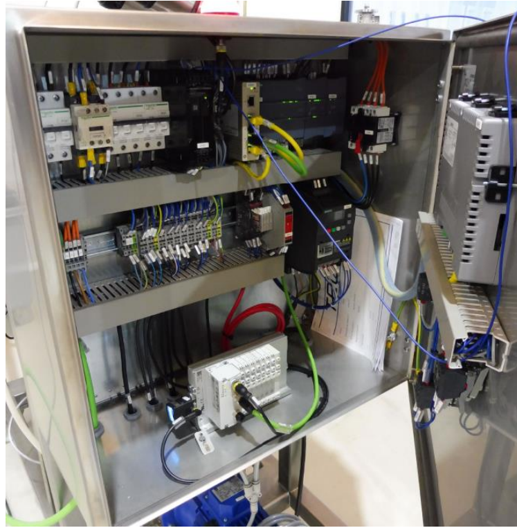
Figura Annex 104: Interior de l'armari elèctric de l'equip CIP
