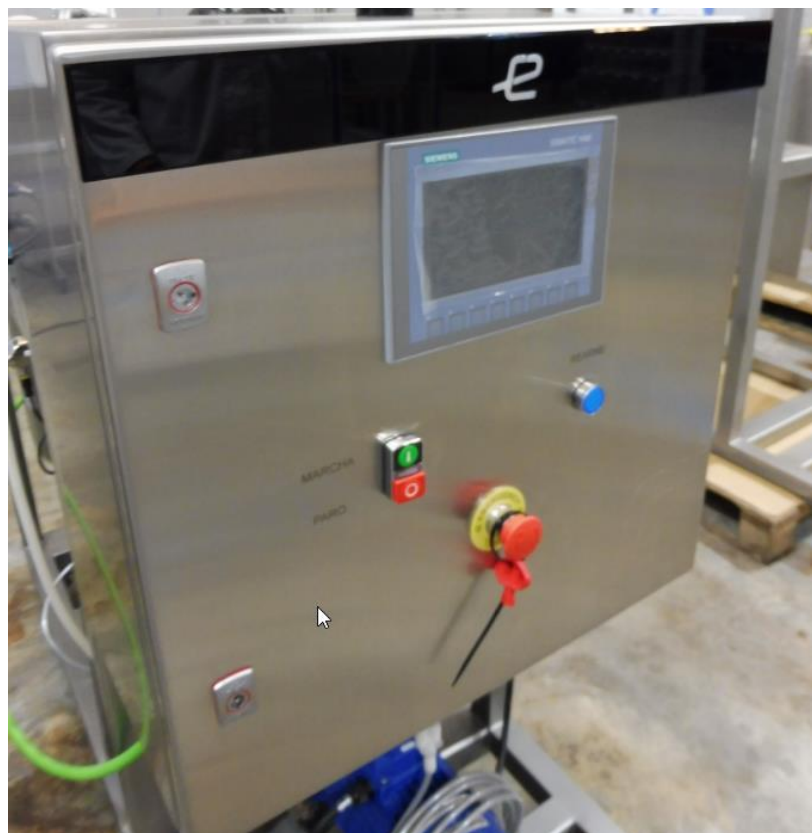
Figura Annex 103: Armari elèctric de l'equip CIP
