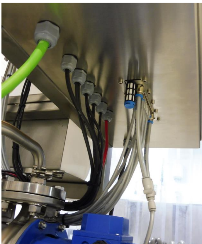
Figura Annex 106: Connexionat inferior de l'armari elèctric de l'equip CIP
