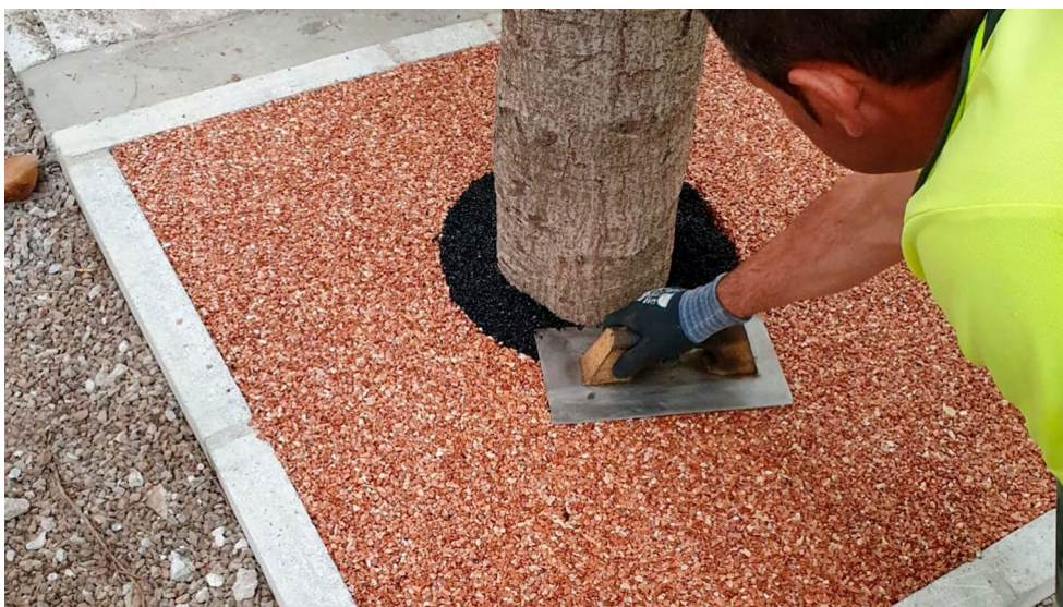
Imatge 42: Aplicació de paviment drenant a escocell a Malaga. Font: Calcel Solutions
