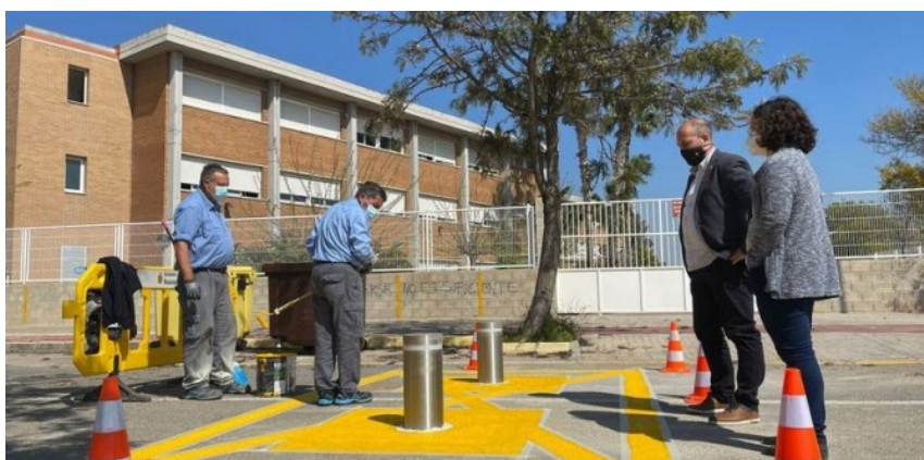
Imatge 17: Instal·lació de pilones automàtiques a l'accés d'un centre escolar Font: nouhorta.eu
