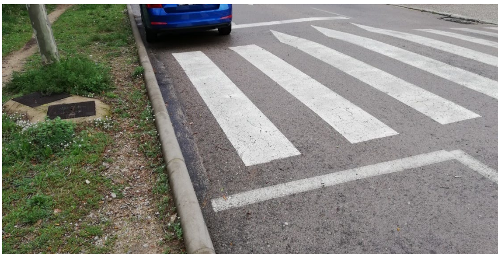
Imatge 28: Pas de vianants sense accessibilitat a vorera no pavimentada. Font: pròpia
