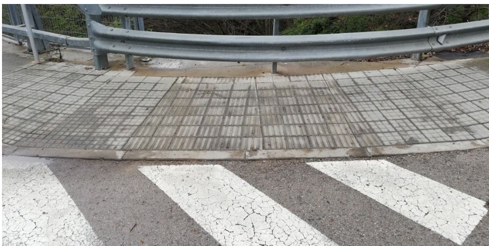
Imatge 26: Pas de vianants amb el paviment tàctil col·locat incorrectament a l'inici del pont. Font: pròpia
