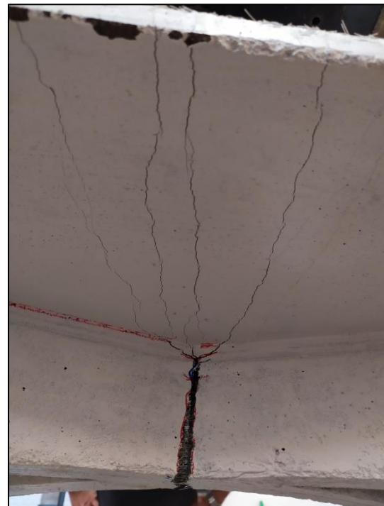
Imatge 45: Aparició fissura horitzontal.
