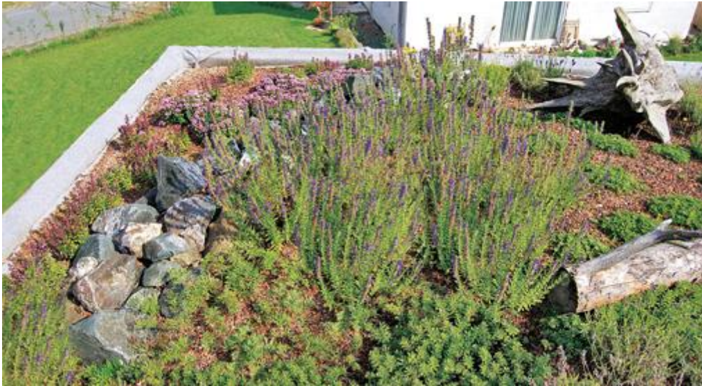
Fig. 4: Coberta extensiva biodiversa. (Zinco, 2018)
