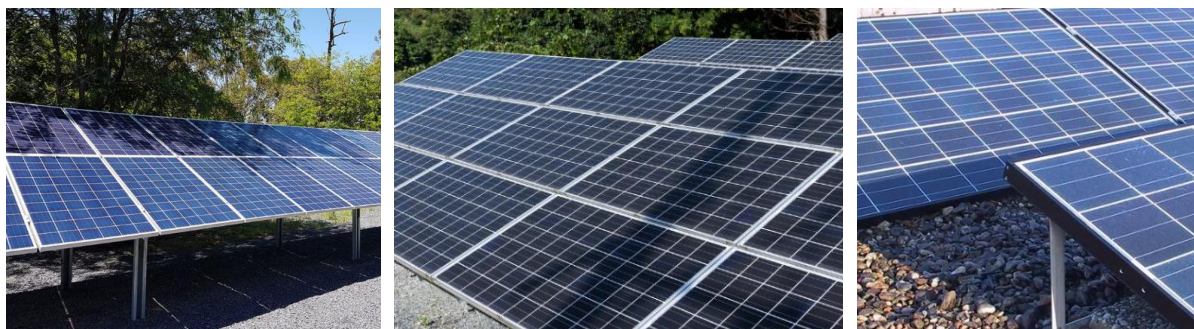
Figura 39. Exemples de ombre sobre plaques fotovoltaïques.
