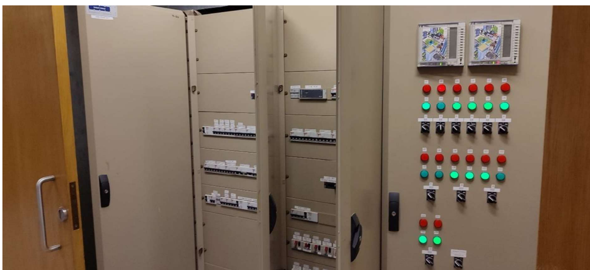
Figura. 30. Quadre principal edifici P4. Font: elaboració pròpia
