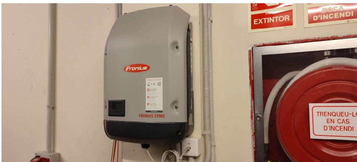
Figura. 32. Inversor existent. Font: elaboració pròpia
