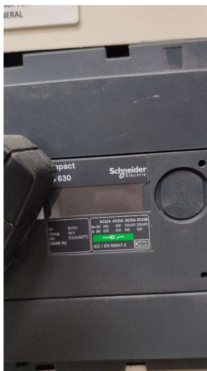
Figura. 26. Interruptor general QP. Edifici P1. Font: elaboració pròpia
