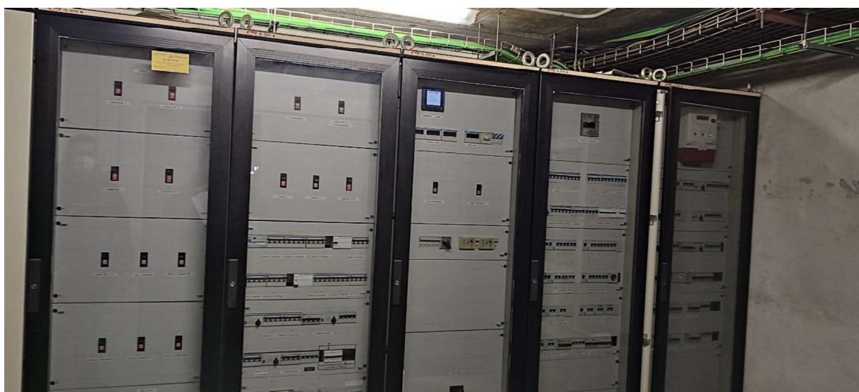
Figura. 28. Quadre principal edifici P2. Font: elaboració pròpia
