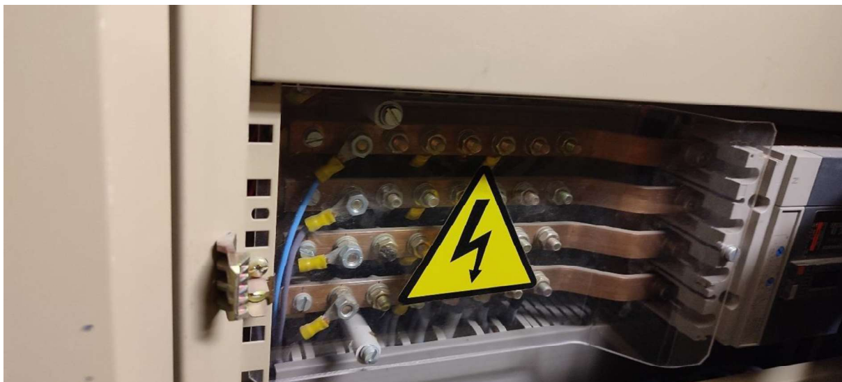
Figura. 31. Interruptor general QP edifici P4. Font: elaboració pròpia
