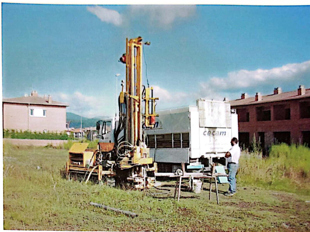
Realització del sondatge 1 amb la penetrosonda TECOINSA TP50-D (11-7-2000). Parcel·la situada al vial Sant Jordi (Olot)
