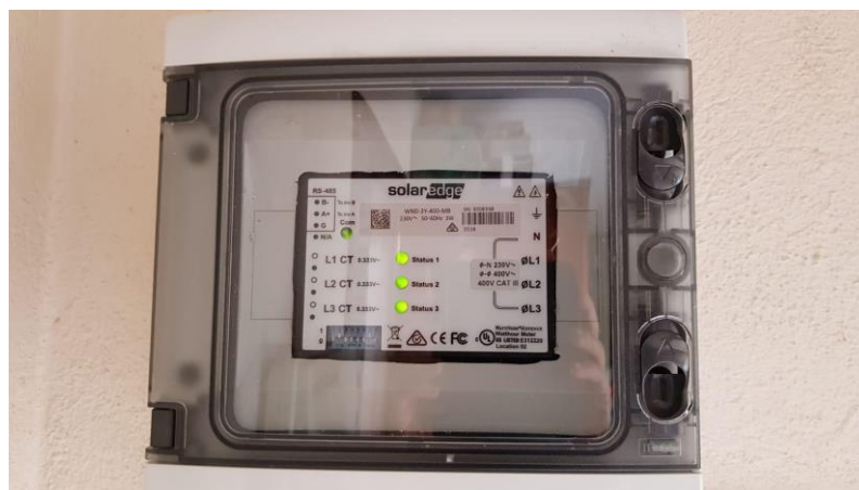
Figura 17. Aparell de mesura instal·lat en caixa de superfície estanca
