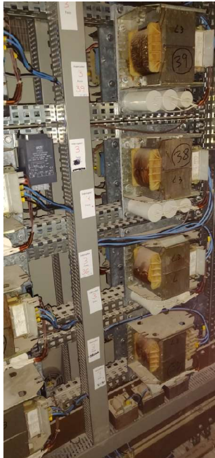
Figura 4. Armari d'equips auxiliars dels projectors existents
