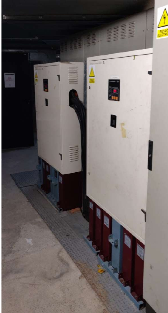
Figura 2. Dues bateries de condensadors al costat dels QGBT existents
