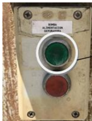
Figura 41 Pulsador enviament d'aigua a l'estació depuradora
