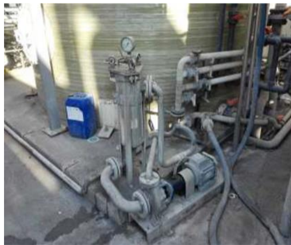
Figura 5 Bomba d'extracció del dipòsit n°2 al tractament F-Q
