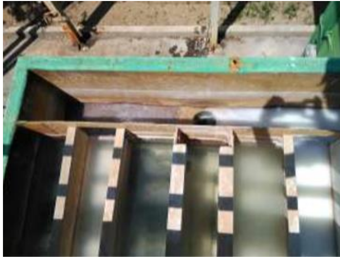
Figura 15 Decantador lamel·lar desnivellat
