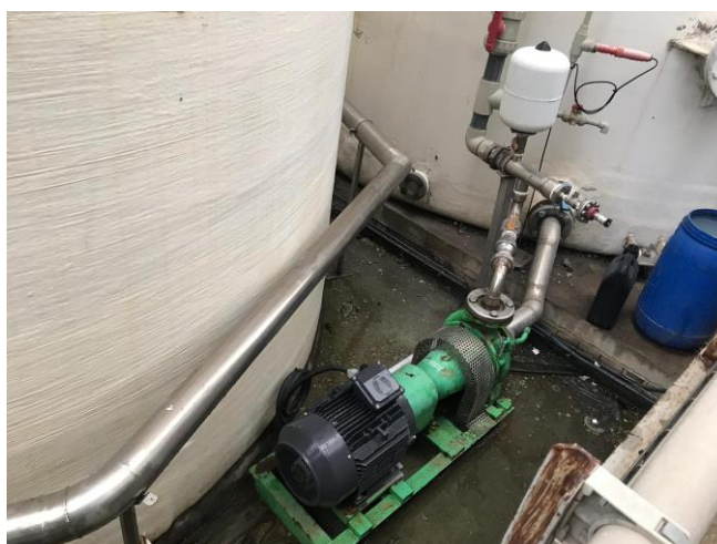
Figura 16 Bomba de recirculació del tanc d'homogeneïtzació n°2 d'on és realitza el mostreig
