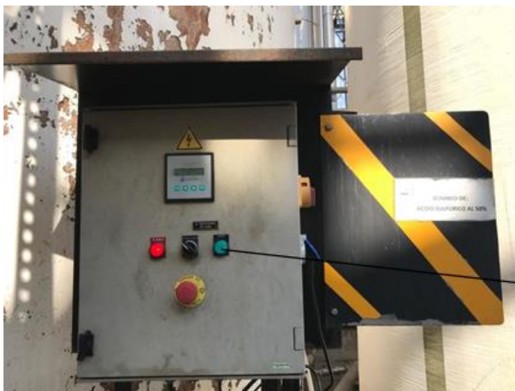
Figura 43 Quadre de control del pH previ de l'E.D.A.R.I
