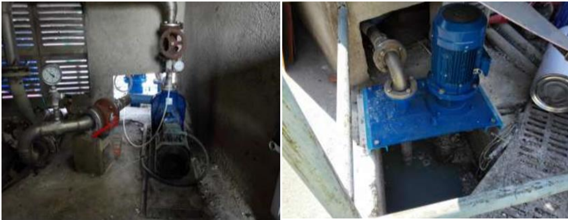
Figura 3 Bombes centrífugues impulsors
