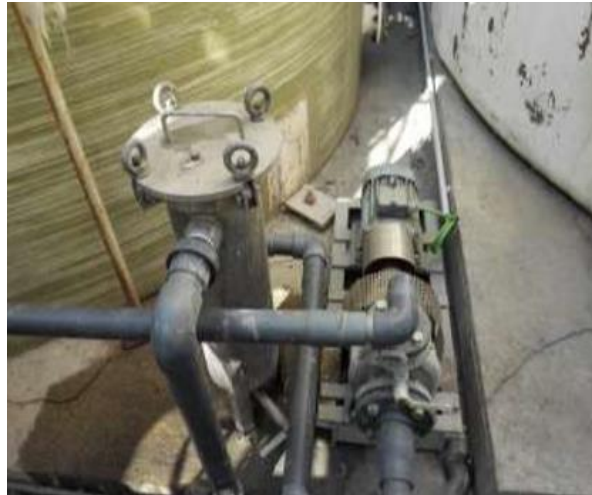
Figura 4 Bomba d'extracció dipòsit n°1 al dipòsit n°2
