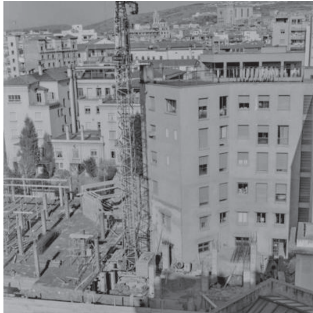
Vista dels pilars de formigó de plantabaixa construïts a posteriori. Ajuntament de Girona. Font OMNIA
