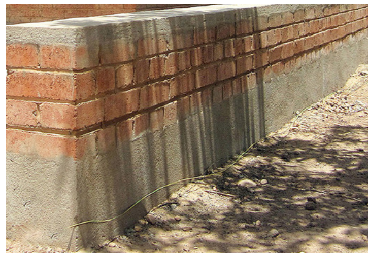
Mur de tancament exterior Semimur de BTC amb base de formigó
