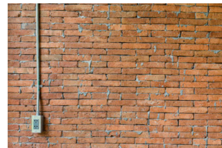
Instal·lació elèctrica vista
