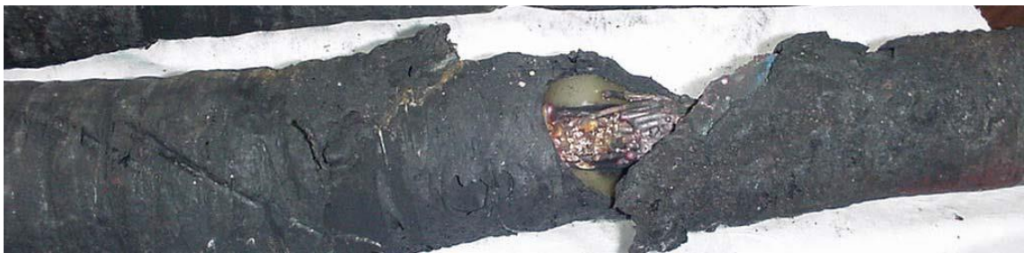
Figura 8: Deteriorament de l'aïllament interior en un conductor de mitja tensió
