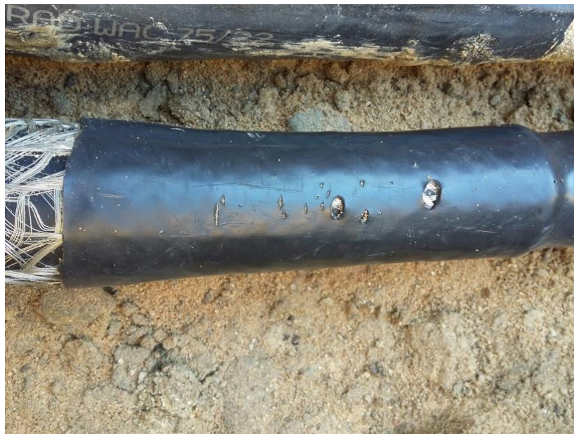
Figura 7 Defecte a la coberta del cable de mitja tensió
