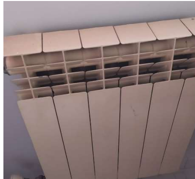
Figura 6. Radiadors actuals. Font: Fotografia propia.
