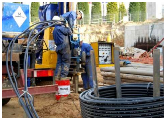
Figura 27. Introducció de la sonda al pou vertical mitjançant un desbobinador. Font: EDASU.
